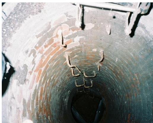
写真 8-6 劣化した足掛け金物
