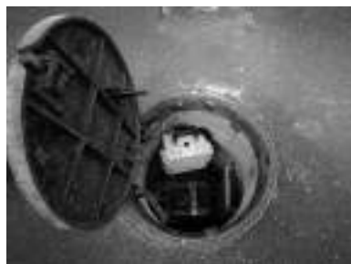
マンホールステーション（WEB監視）
