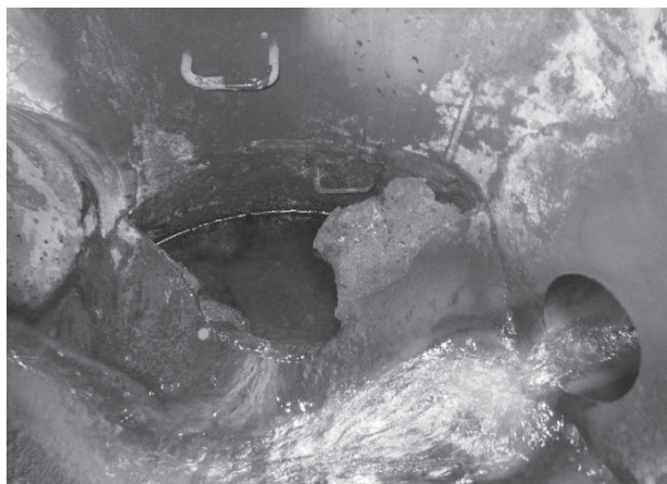
写真10 人孔内インバートの破損状況
