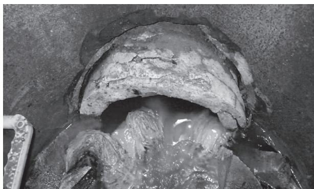
写真1 未対策マンホールの管きよ突込み被害 (能登半島地震)
