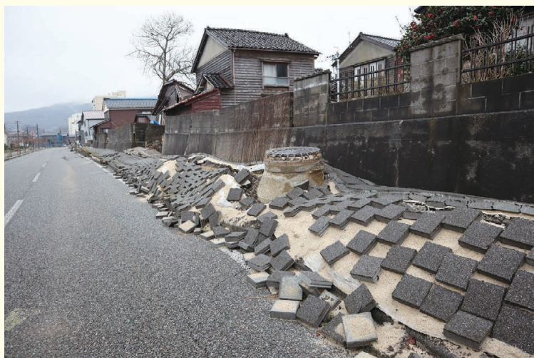
液状化によるマンホールの浮上
