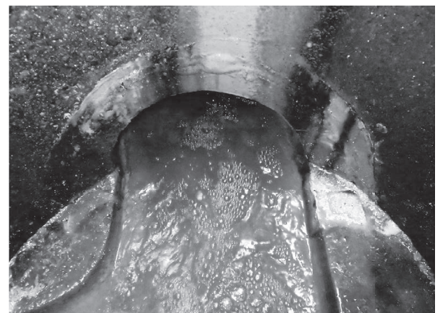
写真3 耐震性能が確認されたマンホール(能登半島地震)
