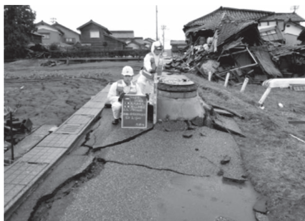
写真―1 マンホールの浮上
