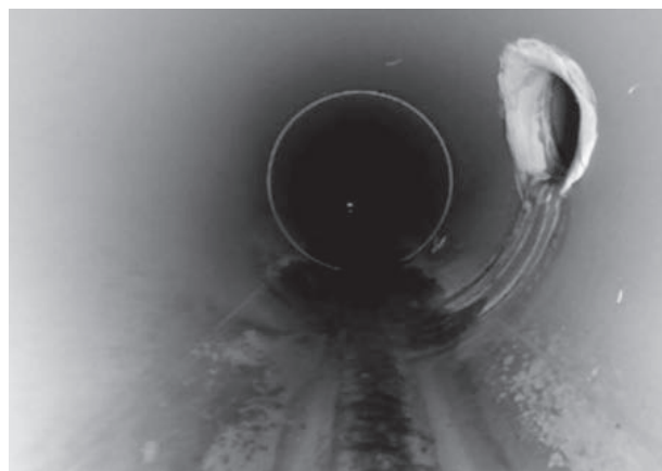
写真2 AS400で撮影した管路内映像
