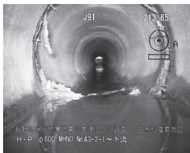
写真-4 破損状況
