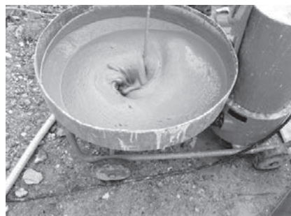
写真-8 グラウトポンプ
