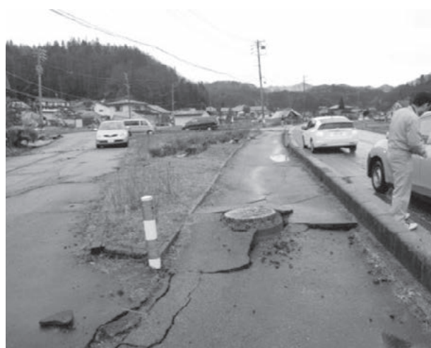
写真-9 マンホールの突出
