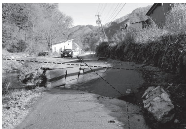
写真-2 段差の発生
