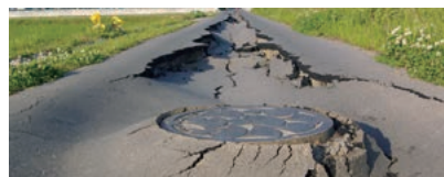
岩手・宮城内陸地震で陥没した道路
