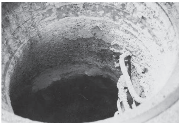
硫化水素などによって内部が腐食したマンホール
