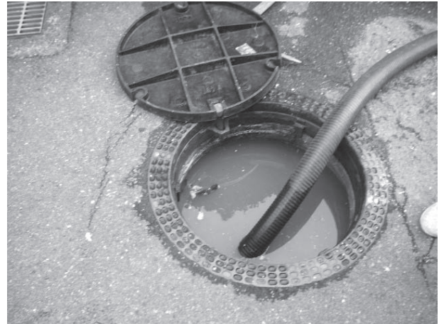
下水の流下機能に支障をきたす例もたびたび発生する
