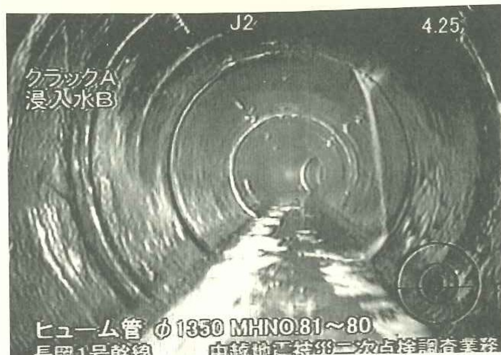
写真-6 ランクAのクラックとランクBの浸入水（ヒューム管）
