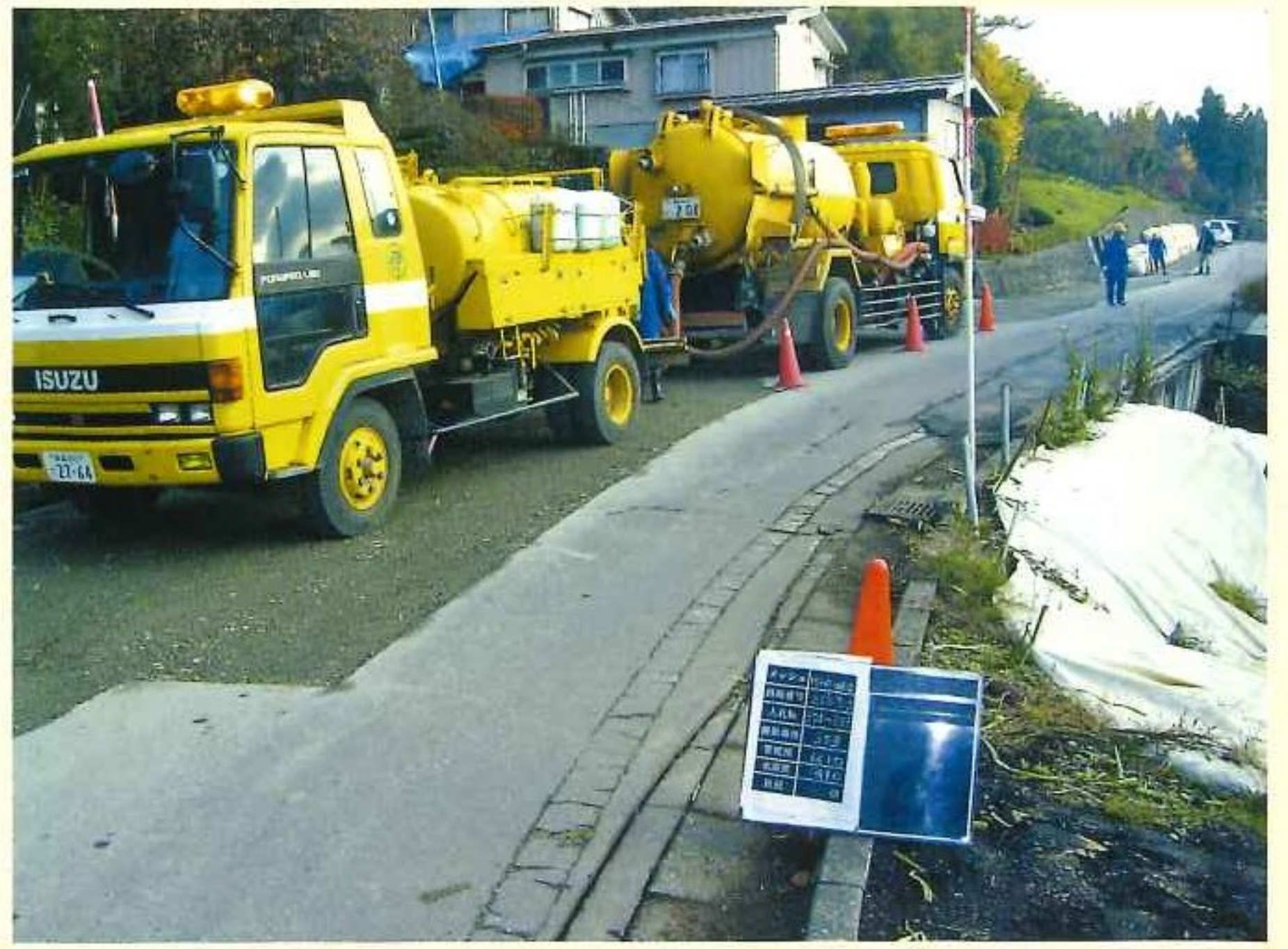
▲土砂崩れ現場付近での調査
