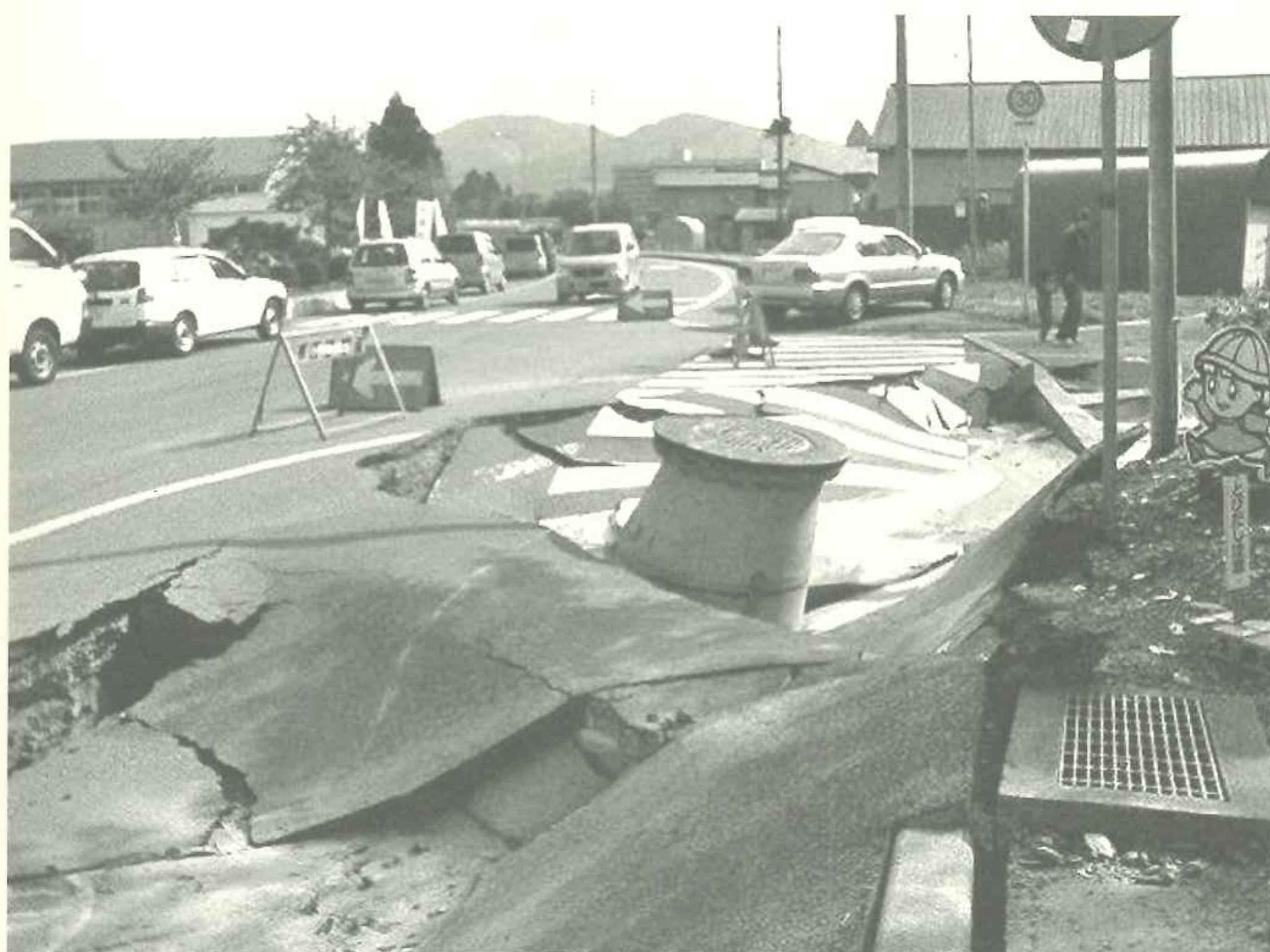
写真-1 地震により隆起したマンホール（小千谷市 千田地内）
