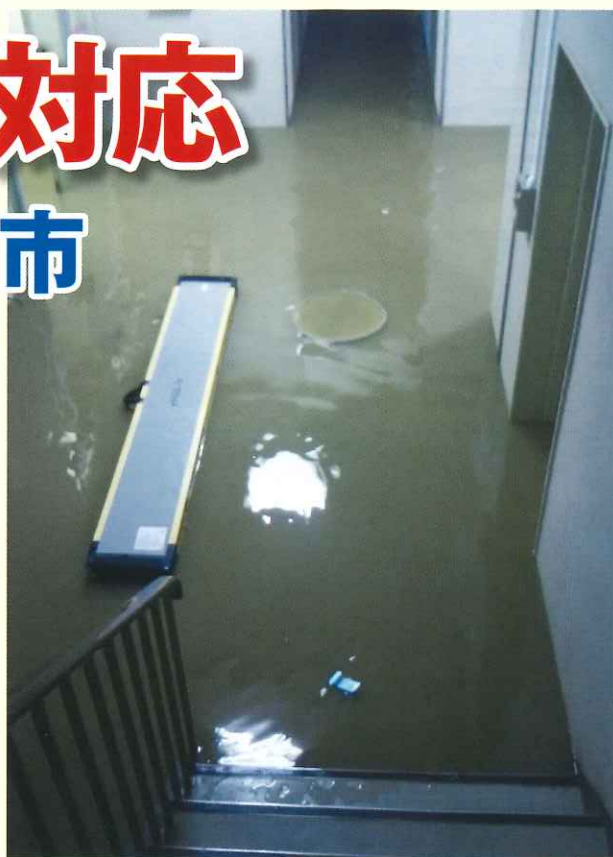
ポンプ場に汚水が流入（三郷町提供）
