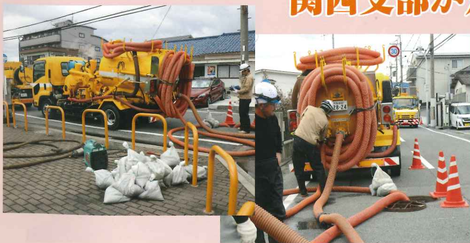
バキュームカーで溢水対応（堺市）
