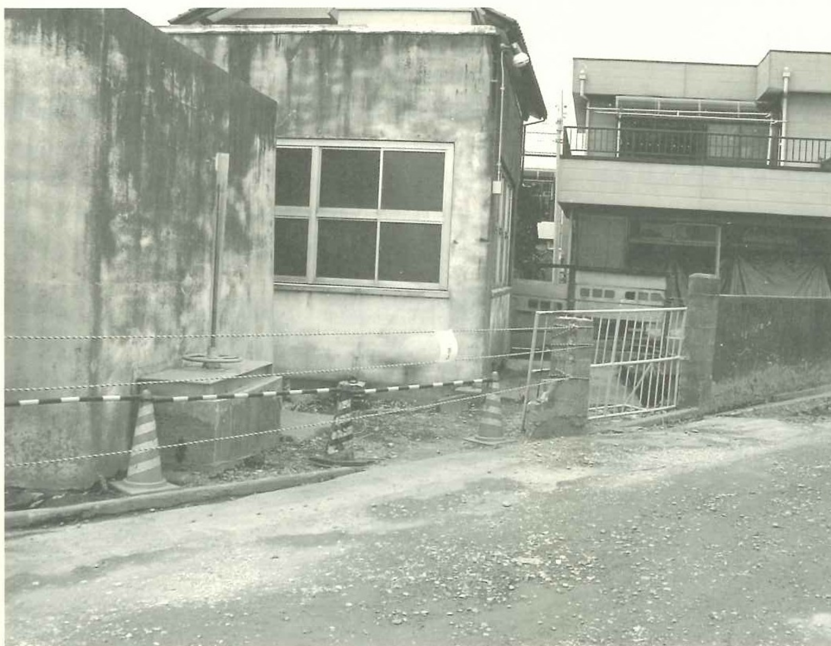
写真-1 被災した木田ポンプ場
