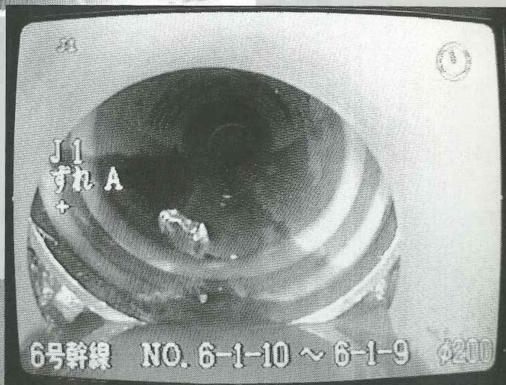
塩ビ管継目部の脱却
