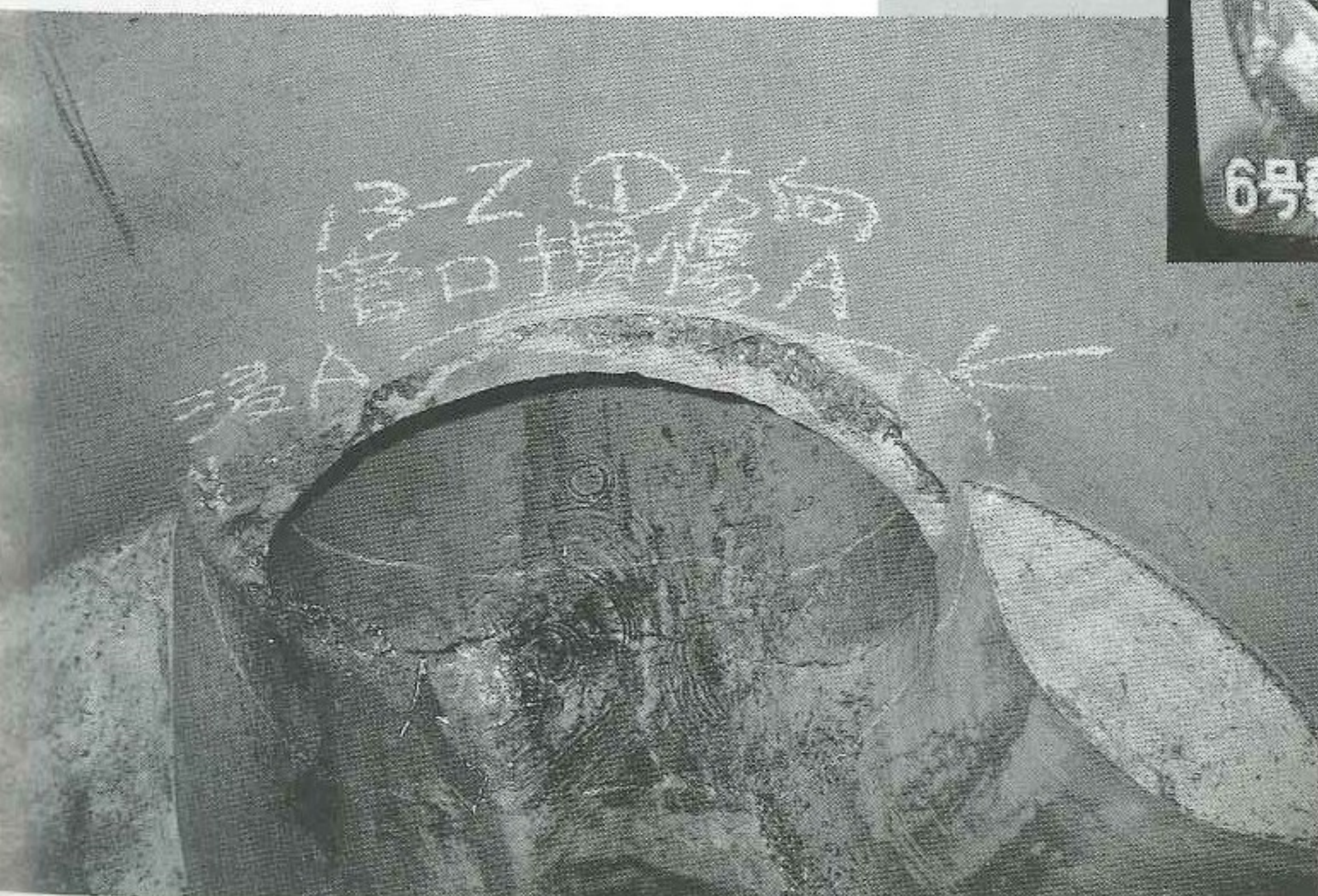
管口部亀裂・接合部モルタルはくり
