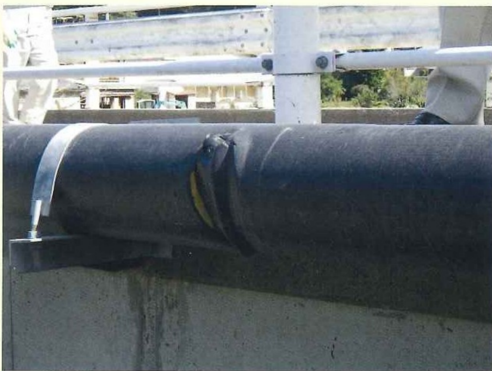
下水道管の蛇行（上）や破損（下）を目視で確認
