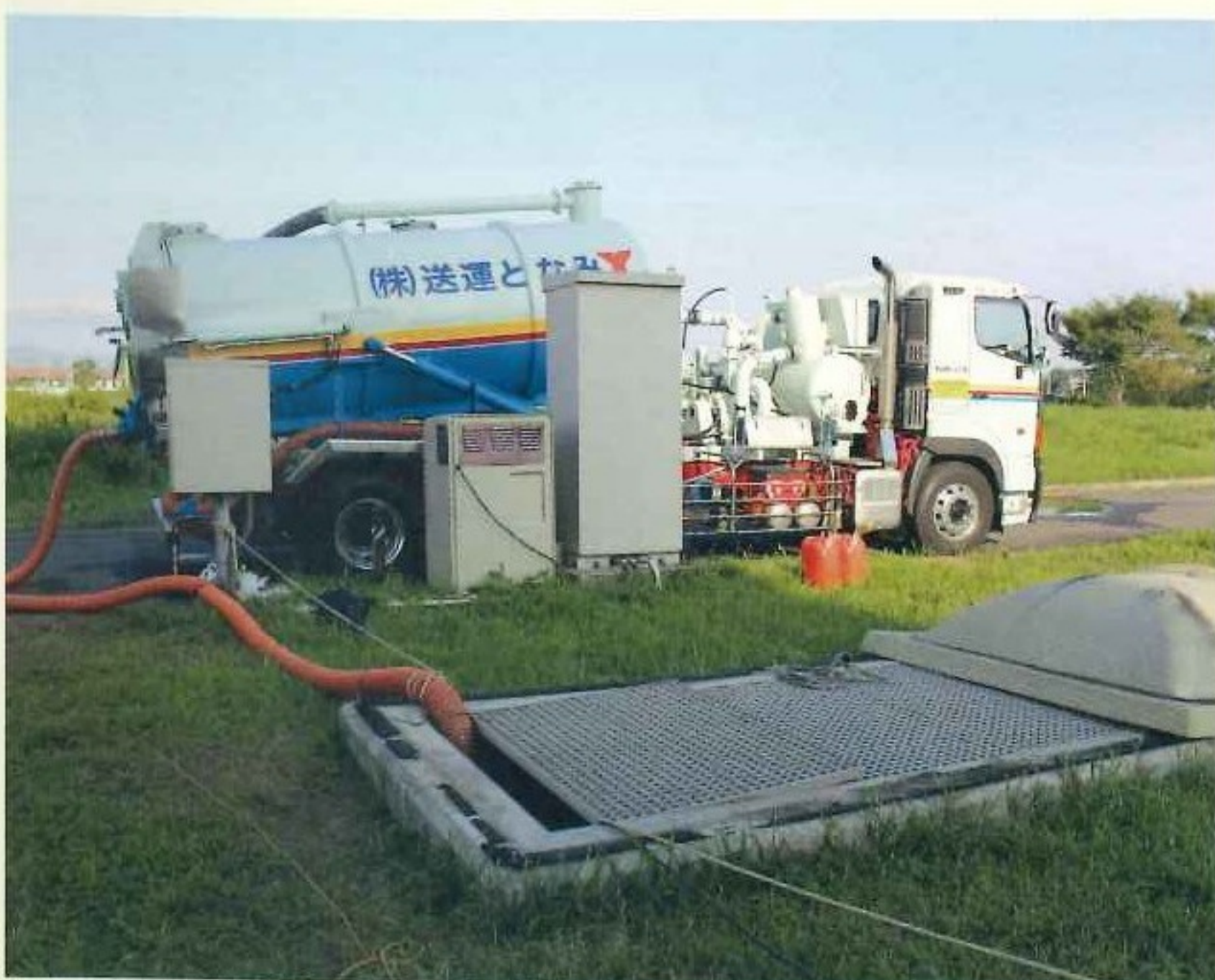
処理場の流入きよに汚水を搬送
